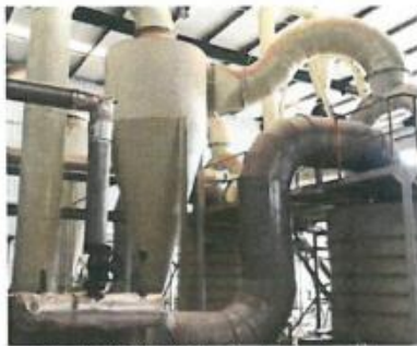
烘干废气多管旋风除尘器
