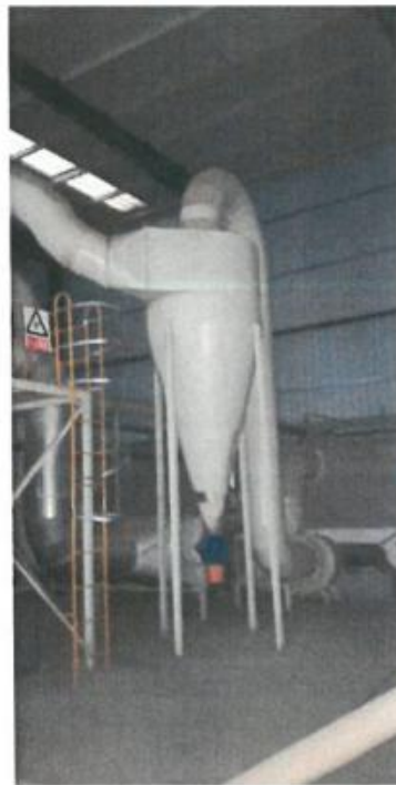
烘干废气多管旋风除尘器
