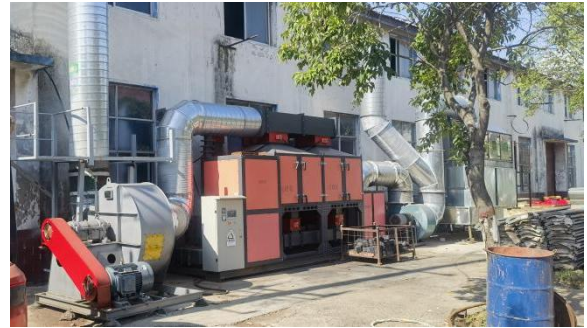
喷漆车间治理设施
