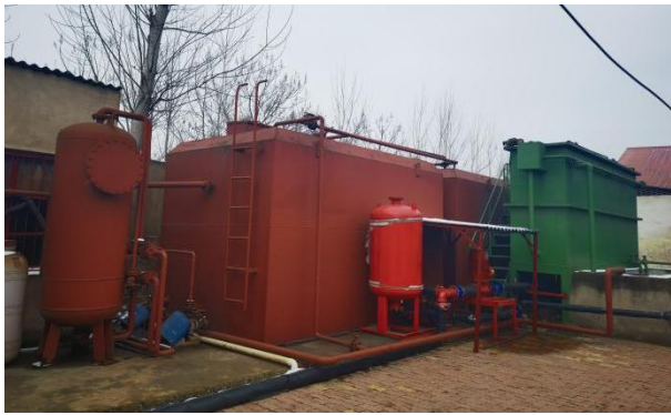
污水处理设施
