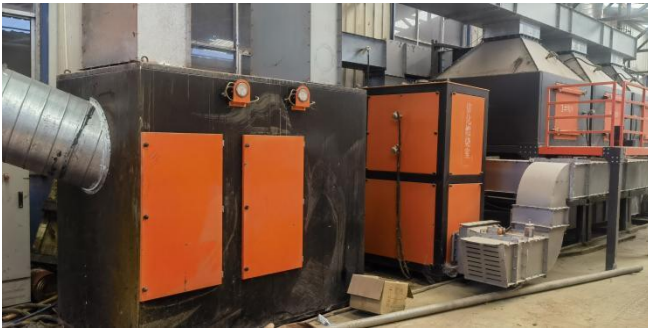
涂装车间治理设施
