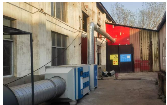
危废暂存间及治理设施
