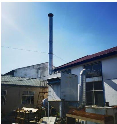
激光切割除尘设施
